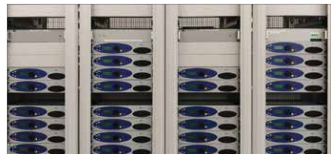
Enkele van de vele ontvangerrekken in het ontvangststation
