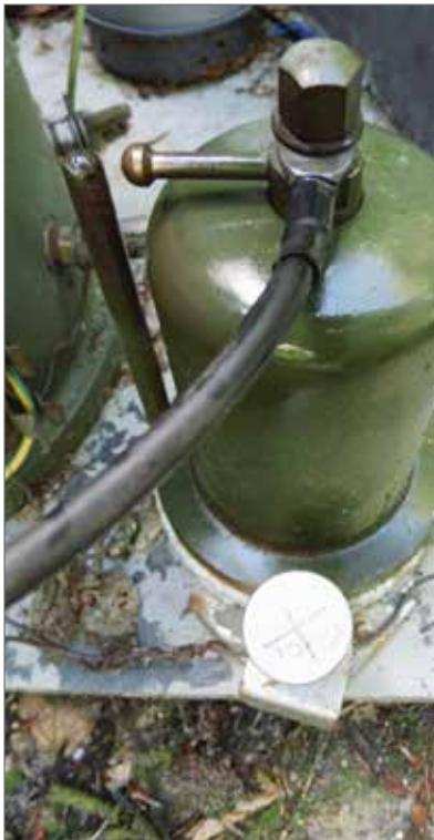
Afbeelding 2: R & S vonkenbrug zoals gebruikt bij 500 W mobiele zendinstallatie.
