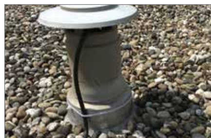
Zonder gat komt de kabel naar buiten
